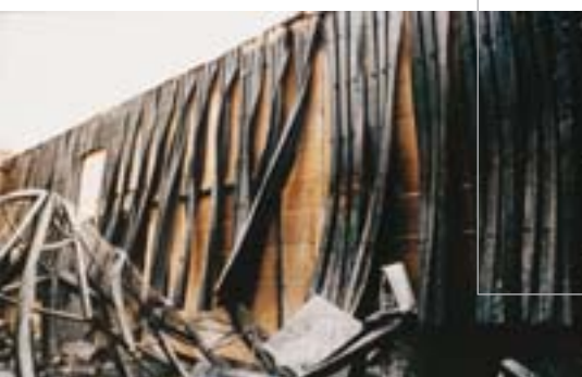
Un feu créé par une source extérieure (incendie, explosion) peut mener à la destruction du bâtiment si la toiture n'est pas résistante au feu.
